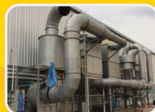
Máy tách cyclone lớn + Máy hút bụi
